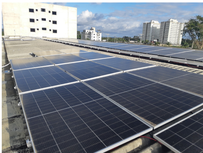
Usina fotovoltaica da SSJ de Vitória da Conquista
