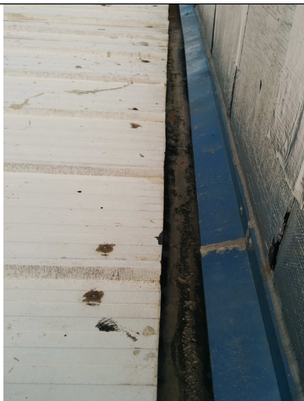
Foto 4 – Vista de calha e rufos oxidados e manta perfurada.
