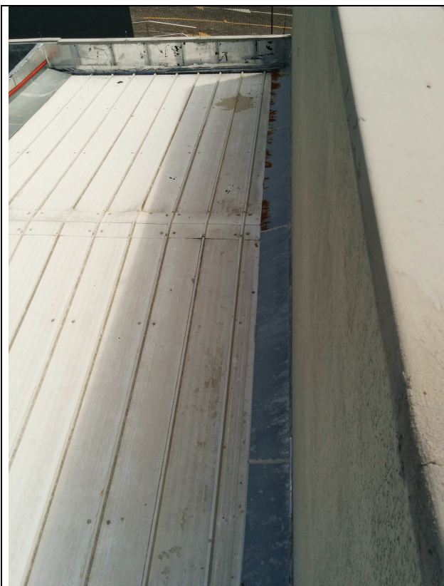
Foto 5 – Vista superior com rufos e calhas oxidados.
