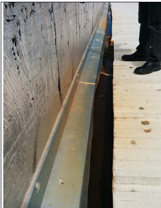
Foto 3 – Vista da da calha oxidada com acúmulo de água por falta de caimento.
